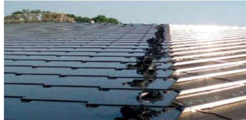
Kuva 36. Aurinkosähköä tuottavia kattotiiliä. (Eriksson Arkkitehdit Oy 2012)
