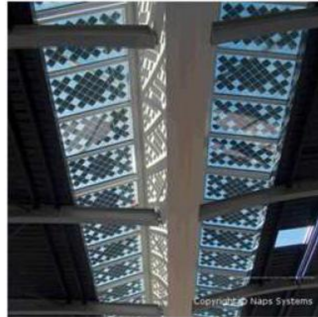
Kuva 39. Marokon Marrakechin lentokentällä kattolaseihin on integroituna aurinkosähköpaneeleita. (Alkuperäinen kuva Naps Systems Oy 2013)
